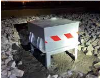
图5 岔区轨件监测系统轨旁设备
